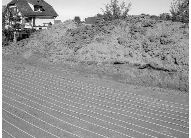
Placement horizontal du circuit de collecte des calories dans le sol du jardin
