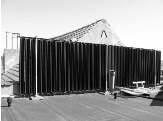
Echangeur air statique placé sur une toiture plate
