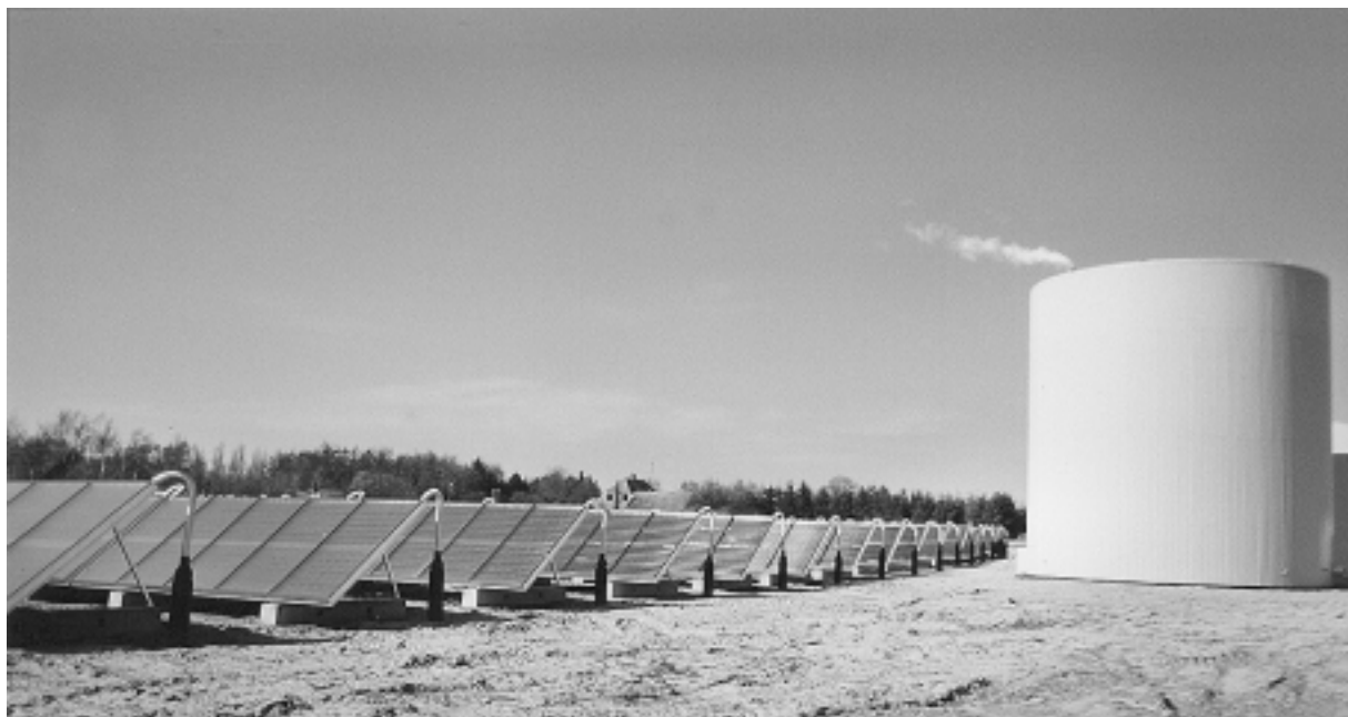
La chaufferie qui alimente l'un des réseaux de chaleur urbains, à partir de l'énergie solaire et de la biomasse
