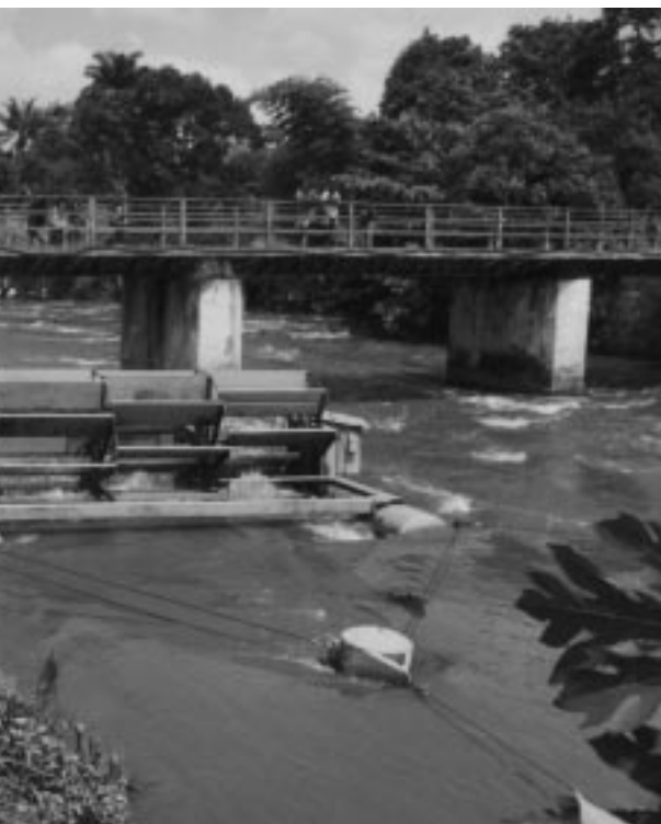
Hydraulienne sur la rivière Ndjili près de Kikimi à 26 km de Kinshasa (installée depuis 2000)
